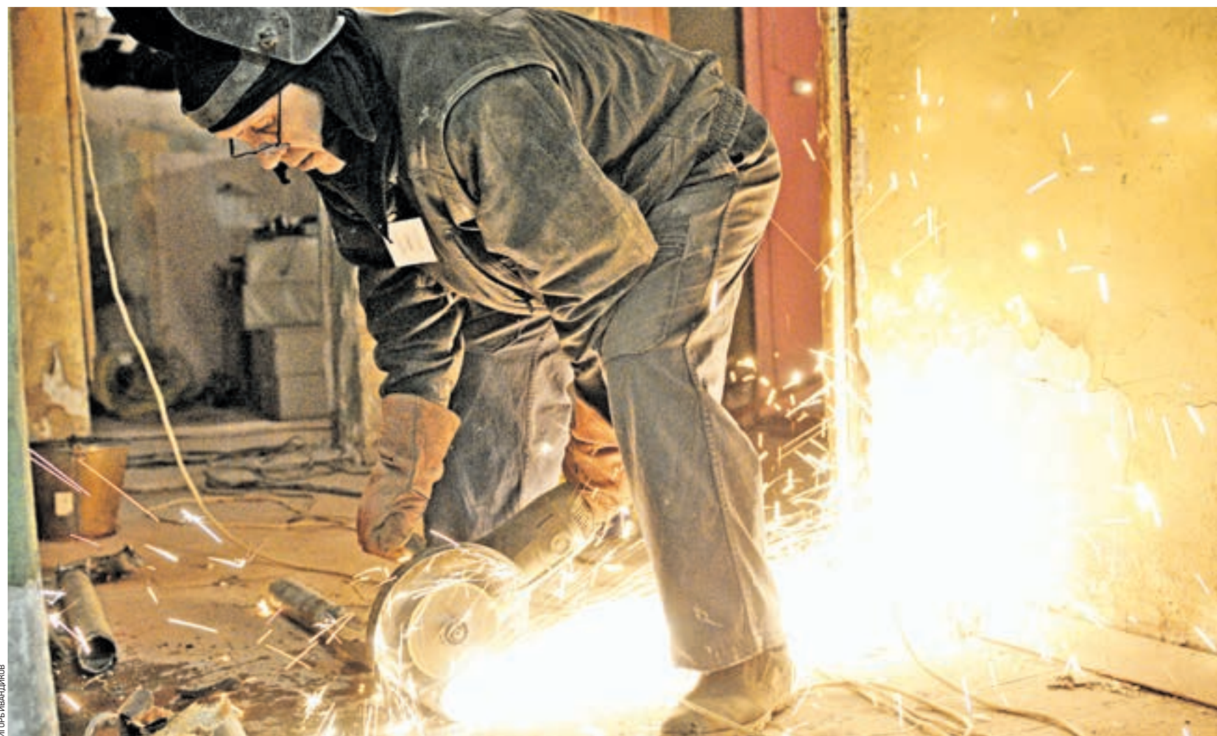
23 декабря 2015 года 12:50 Сварщик Владимир Старушко ремонтирует подвал дома по 1-й Владимирской улице. Перекладка коммуникаций в подвале дома — только часть комплексной программы капитального ремонта. В нее входит также ремонт фасадов, кровли и внутренней отделки здания
