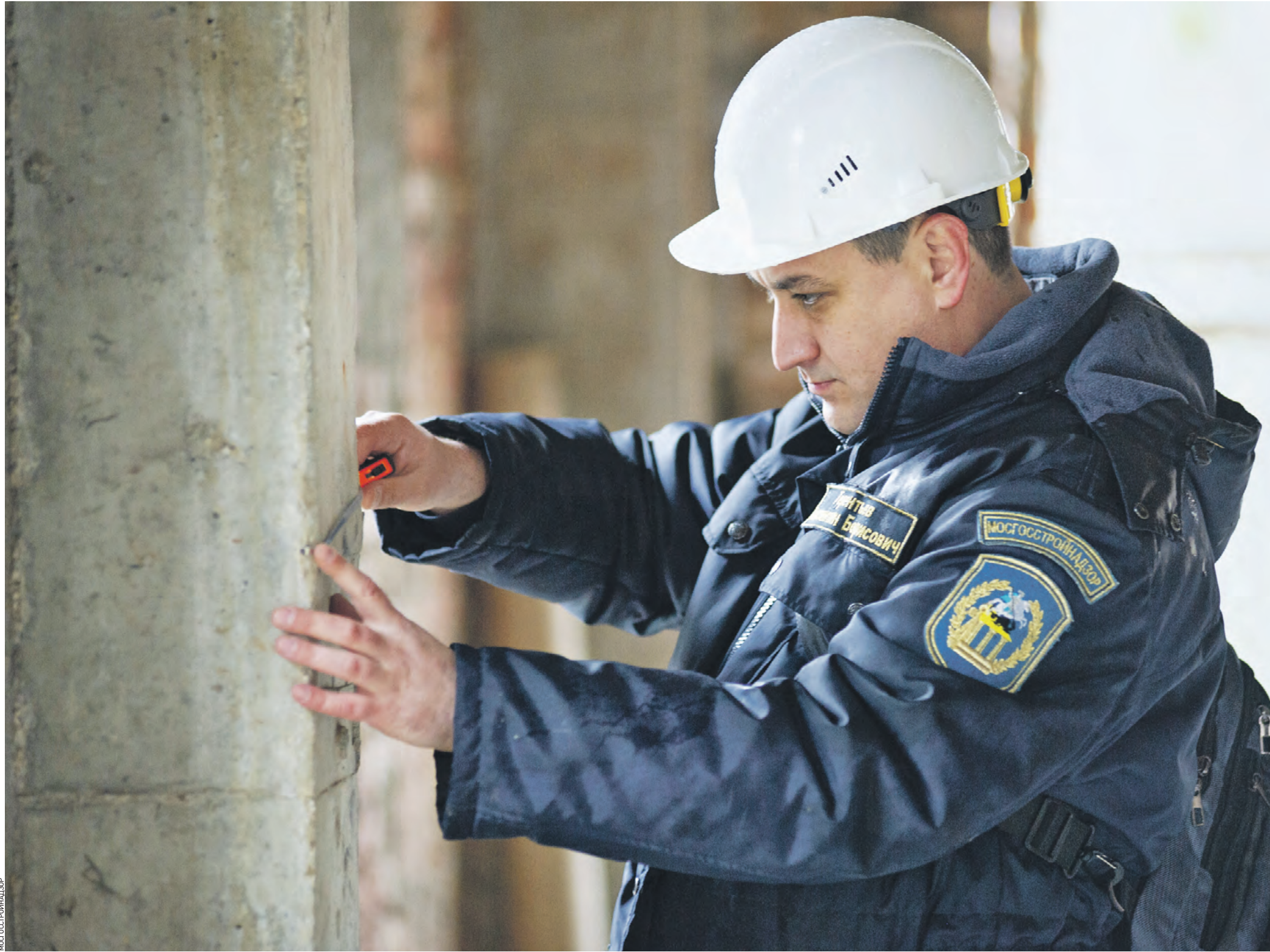
18 октября 2023 года. Инспектор Управления надзора по ТиНАО Константин Терентьев осматривает строящийся объект и проверяет толщину бетонной конструкции
