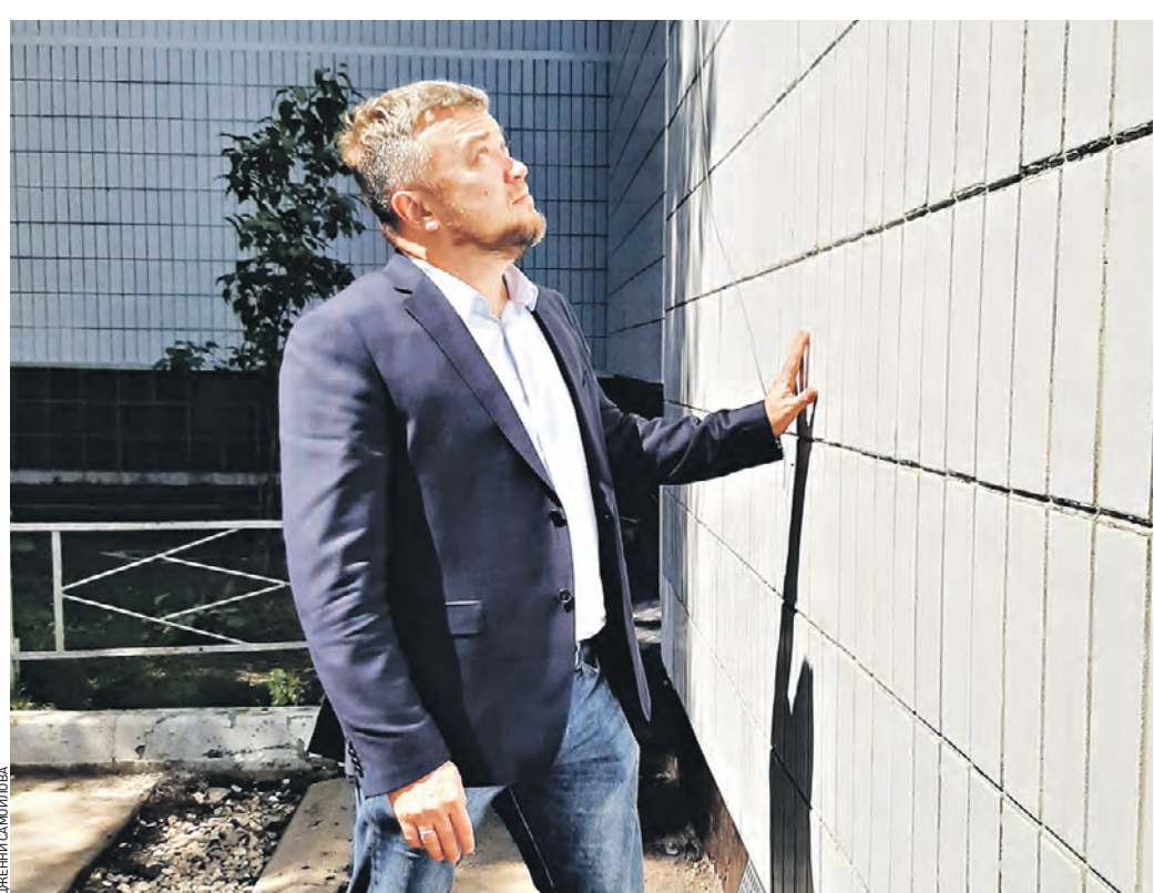
Вчера 13:25 Заместитель генерального директора столичного Фонда капитального ремонта Москвы Павел Рябенко осматривает ремонт фасада жилого многоквартирного дома
