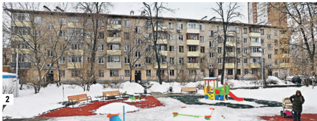
Вчера 18:21 Жительница дома № 14 по улице Амундсена Юлия Белова показывает результаты экспертизы. Она считает, что решение собственников было сфальсифицировано (1) Пятиэтажку, которую вернули в программу, возвели в 1962 году. Она сильно обветшала (2)
