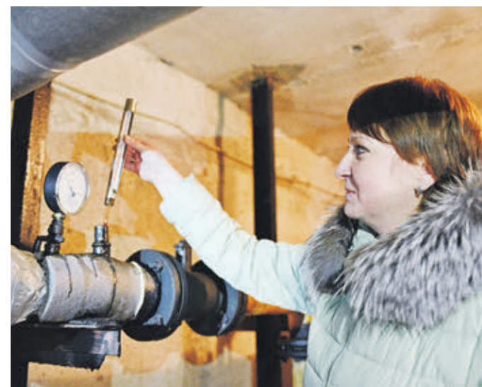
Вчера 14:18 Глава отдела ЖКХ управы района Чертаново Центрального Елена Жукова проверяет систему отопления
