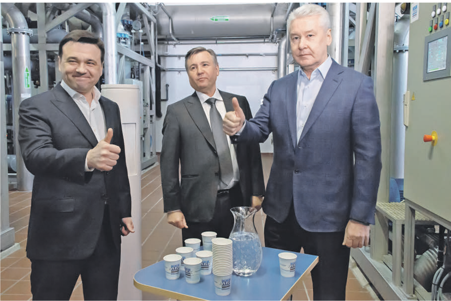
Вчера 11:15 Справа налево: мэр Москвы Сергей Собянин, генеральный директор «Мосводоканала» Александр Пономаренко и губернатор Московской области Андрей Воробьев высоко оценили качество очистки воды на Западной водоочистной станции
