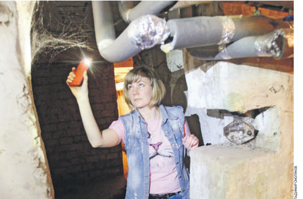
Вчера 12:35 Жительница поселка Дом отдыха Вороново Наталья Макарова показывает корреспонденту «ВМ» аварийное состояние коммуникаций и самого подвала в их доме
