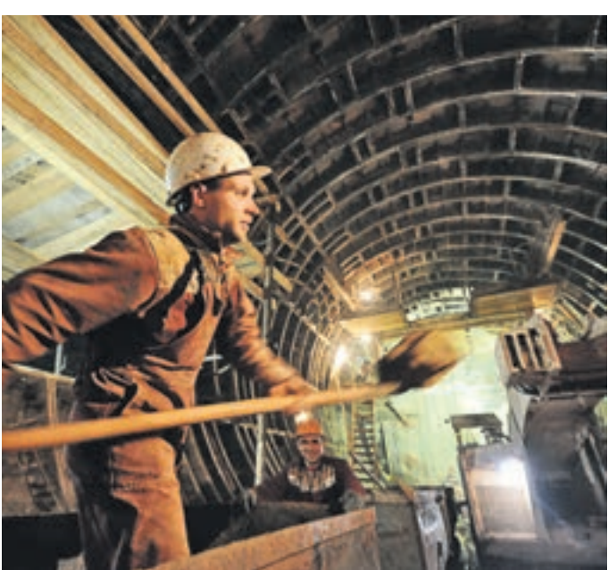
Вчера 13:48 Бригадир СМУ-1 Мосметростроя Игорь Дрючков очищает вагонетку от песка на строящейся станции «Верхние Лихоборы»
