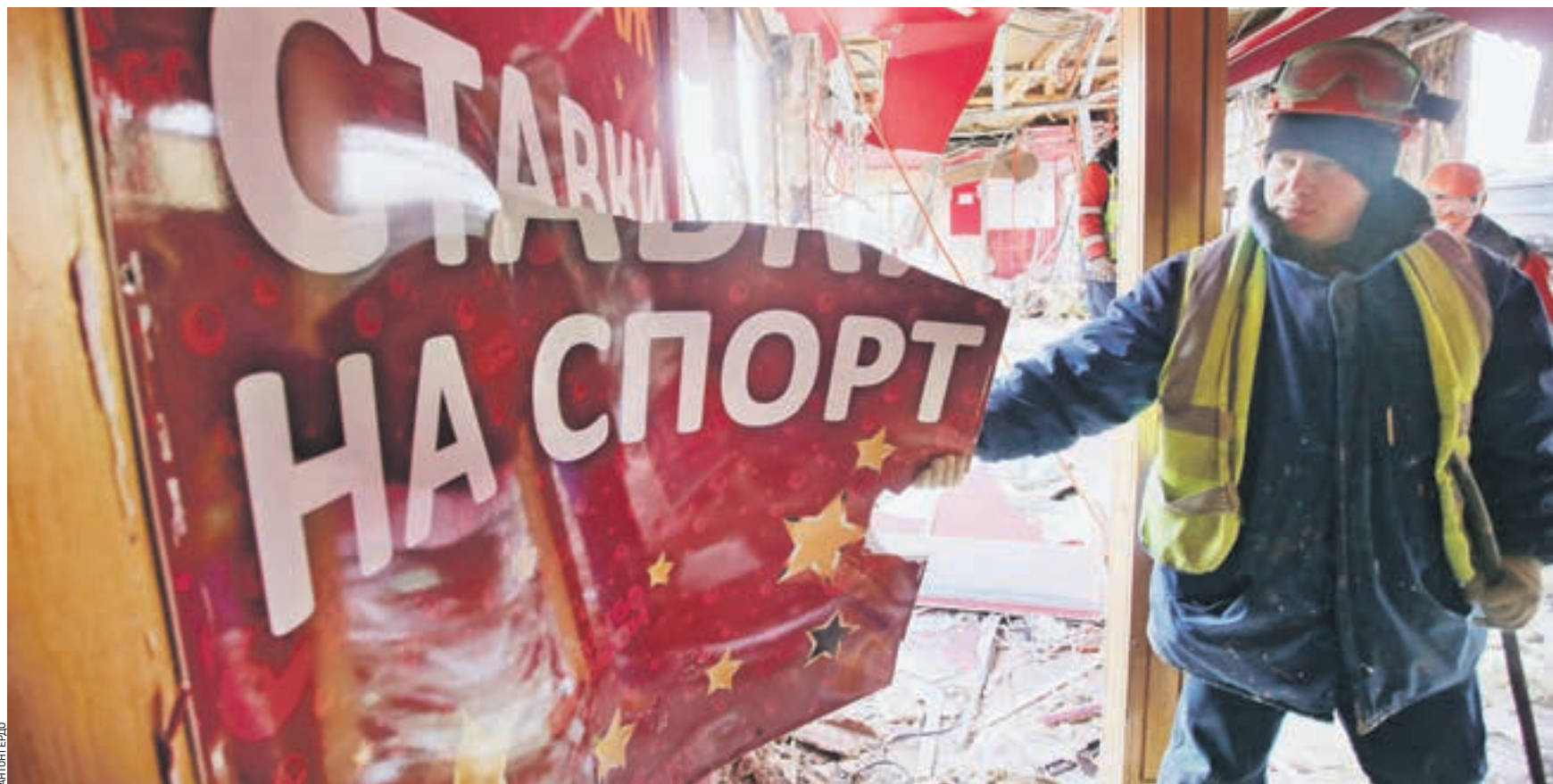
9 февраля 2016 года 14:15 Бригада государственного бюджетного учреждения «Гормост» сносит незаконные постройки, расположенные над пешеходным переходом через проспект Мира возле станции метро «Алексеевская». В конце августа демонтируют еще 84 самостроя, находящихся в охранной зоне метрополитена
