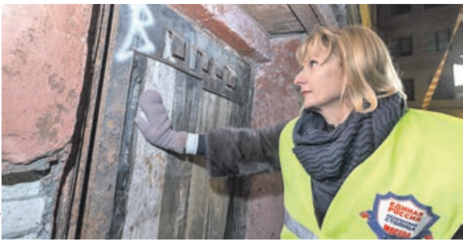
26 ноября 2015 года 19:28 Депутат Мосгордумы Инна Святенко обнаружила незапертую дверь, которая ведет в подвал заброшенного дома. Повесить замок должна управляющая компания
