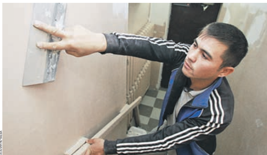
Вчера 15:45 Мастер-штукатур Валерий Ибрагимов выравнивает стены в подвале дома № 23 в 3-м Самотечном переулке. В доме отремонтируют и внутридомовую систему электроснабжения
