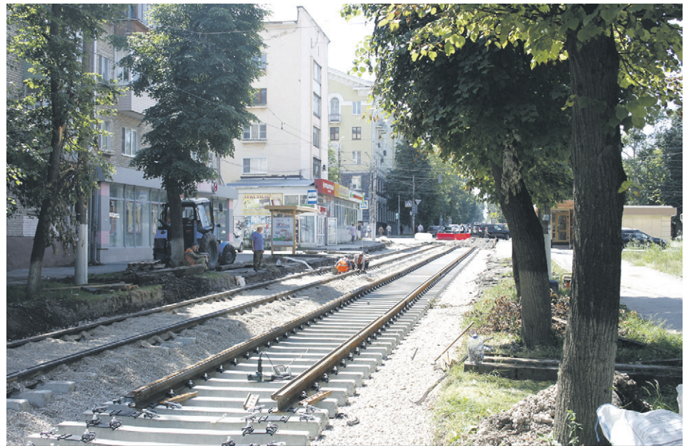
Так сейчас выглядит пересечение Ф. Энгельса с ул. Первомайской. Участок начали ремонтировать в первую очередь.
