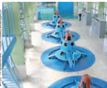
Машинный зал головной насосной станции Саратовского оросительно-обводнительного канала им. Е.Е. Алексеевского.
