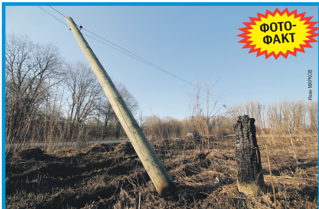
Поджоги травы в Черняховском районе привели к локальному ЧП. Этот столб рядом с поселком Жаворонково находится в таком состоянии уже несколько дней, но местные жители еще надеются, что к ним приедут монтеры.
