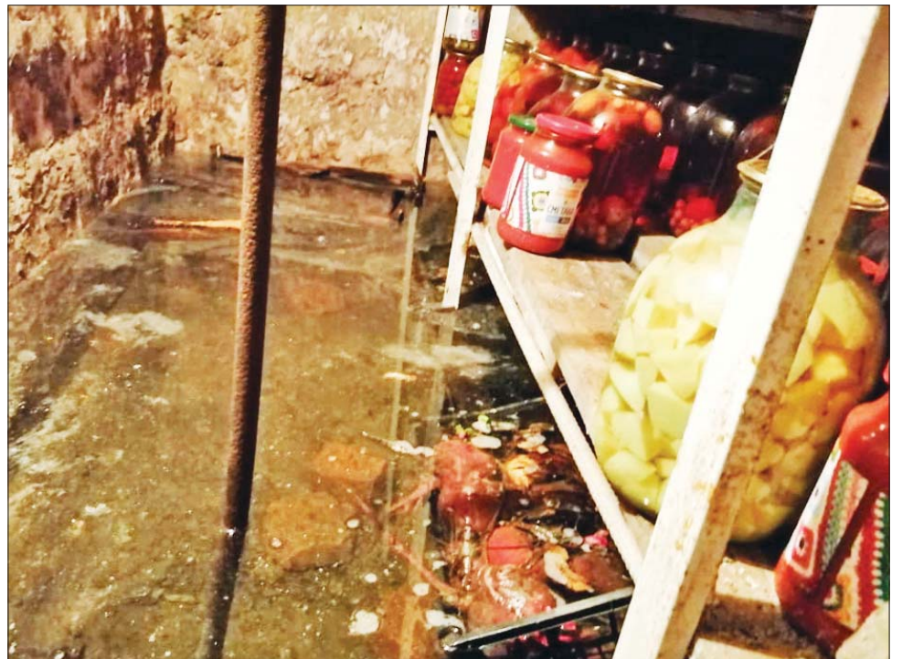
Вода в подвале по колено.
