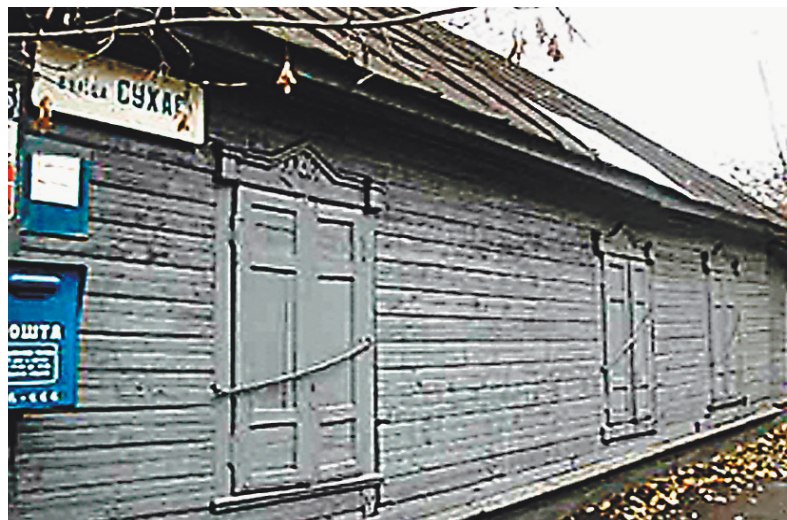
Под домом в 80-метровом подвале жили, болели и умирали 26 человек.
